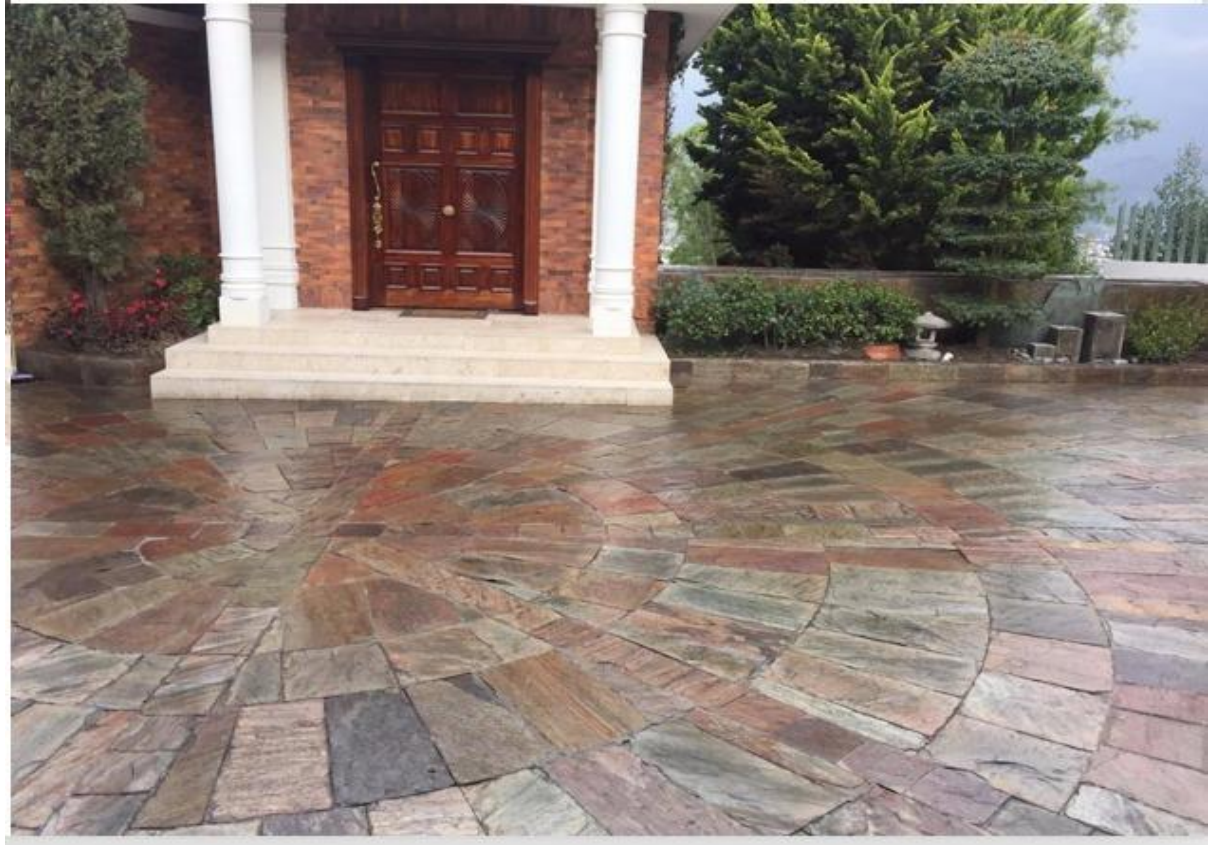
FIGURE 8 DESPUES DE APLICACIÓN DE SELLADOR PROTEX PROSEAL ACABADO BRILLANTE EN ÁREA DE PARQUEADERO [OBRA ENRÍQUEZ CUMBAYÁ, PICHINCHA]
