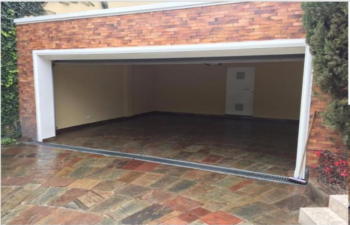
FIGURE 7 DESPUES DE APLICACIÓN DE SELLADOR PROTEX PROSEAL ACABADO BRILLANTE EN ÁREA DE PARQUEADERO [OBRA ENRÍQUEZ CUMBAYÁ, PICHINCHA]
